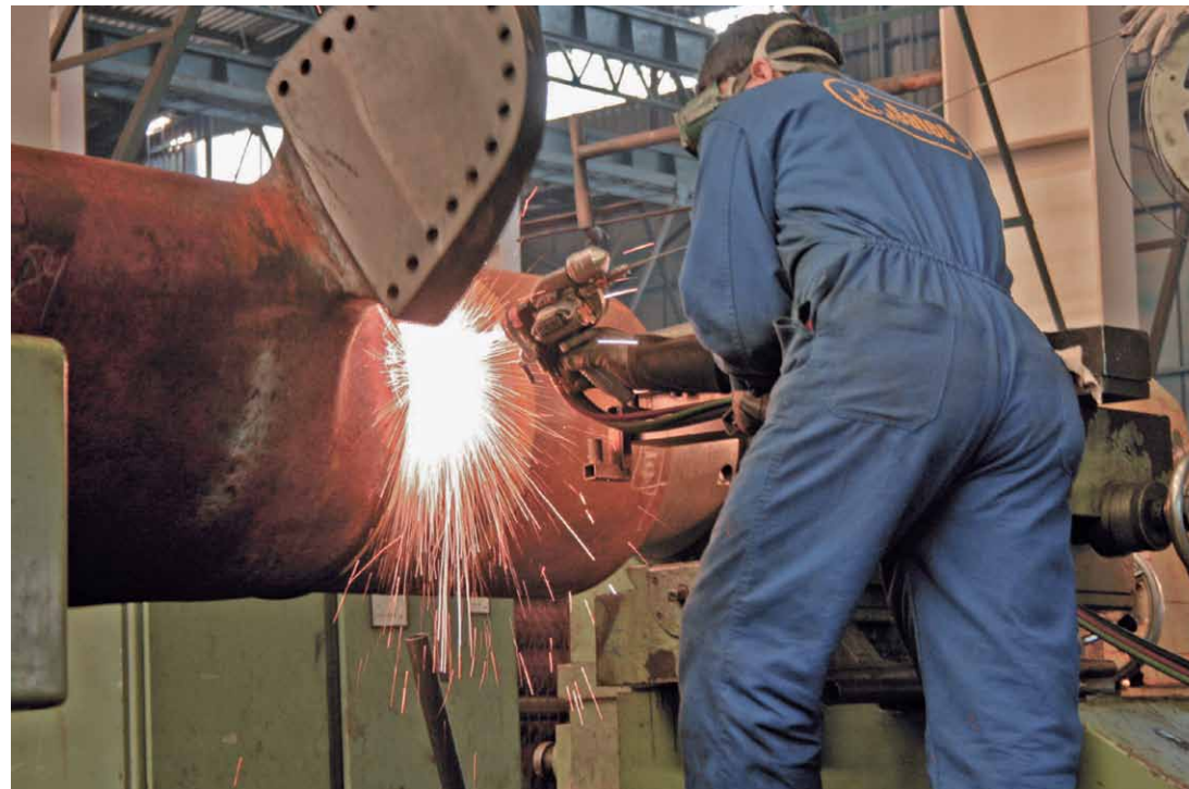
Recuperación con Sistema de Proyección Térmica (Metalizado) Recuperación Eje de Mecha de Timón
